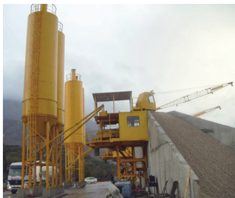
Сл. 2.6. Стационарна фабрика за бетон
